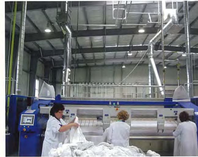
Im Abgaskamin der 2-Roller-Gasmangel von Black & White wurde ein Lamellen-Wärmetauscher von Waretex – Wätas installiert.
