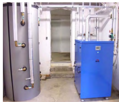
Heizkessel und Mini-BHKW "EPS 4"
